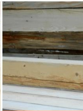
ТРЕЩИНЫ И ГНИЛЬ
